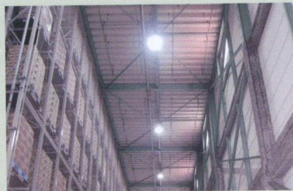
高天井倉庫照明 某清涼飲料製造メーカー様
